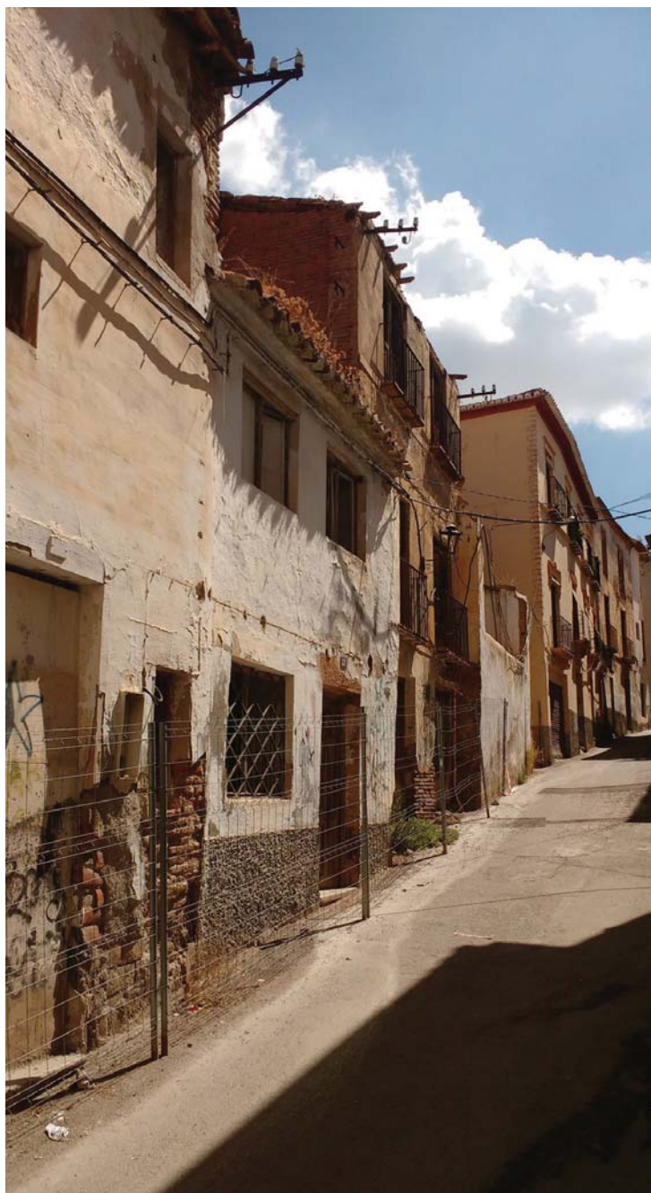
Lám. 8. Casas ruinosas de la calle Santa Ana. Foto: J.M. Gómez-Moreno.
